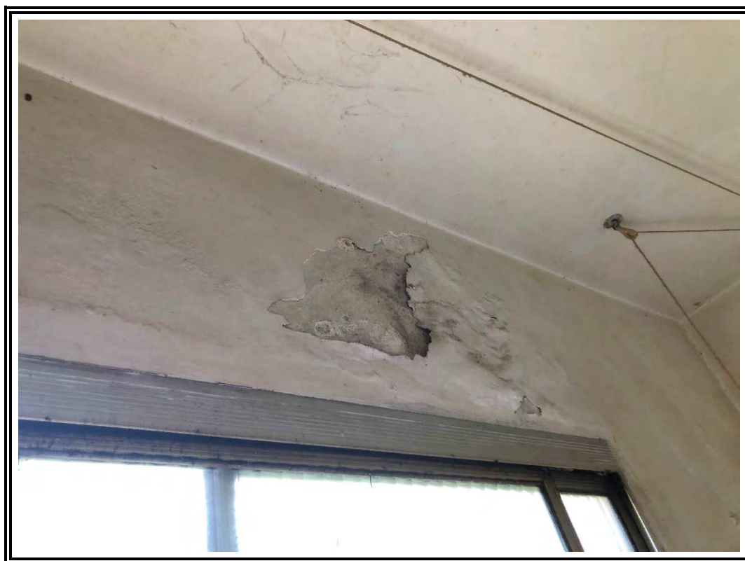
Foto nº 17: Vista da parede da área de serviço com detalhe do acabamento comprometido devido a infiltração
