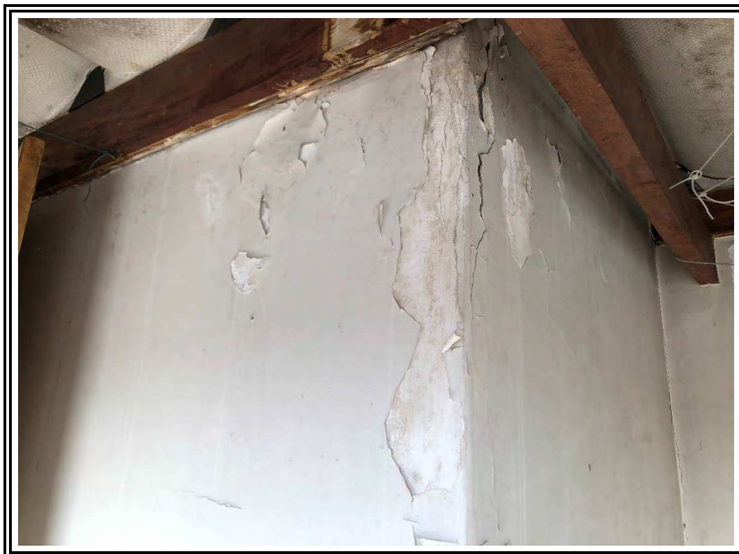
Foto nº 27: Vista da parede com acabamento comprometido e trincas
