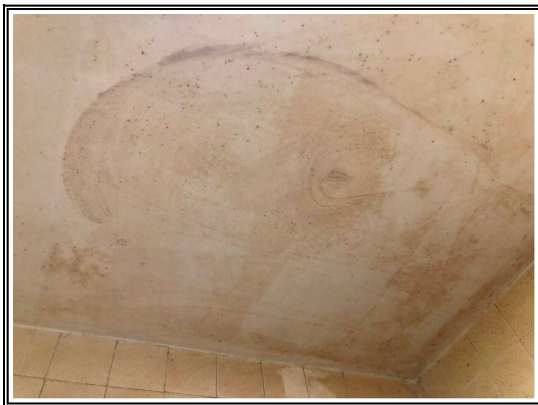
Foto nº 15: Vista do forro da cozinha com sinais de umidade por infiltração
