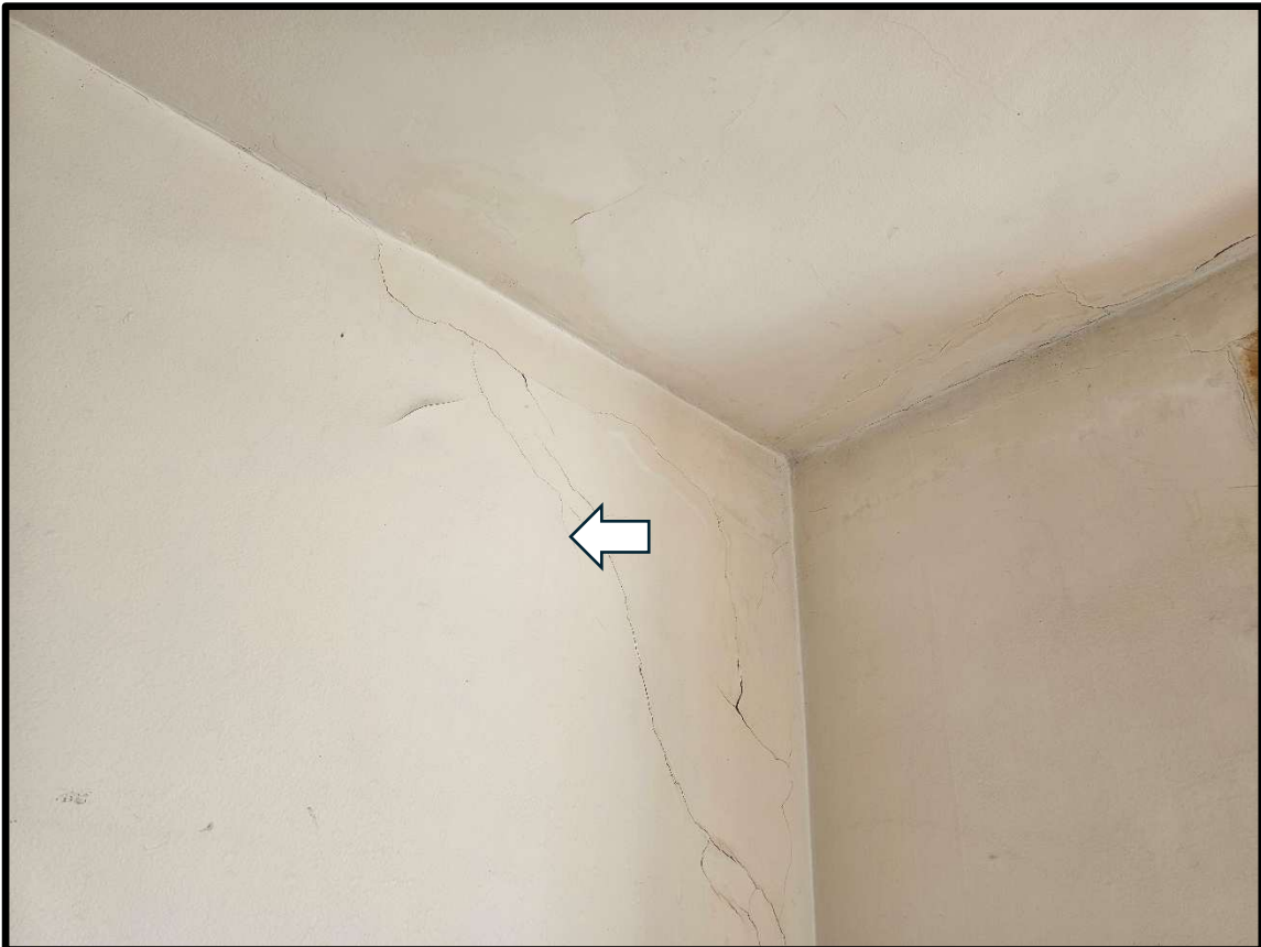
Figura 29: Despensa - Fissuração (1º Pavimento)
