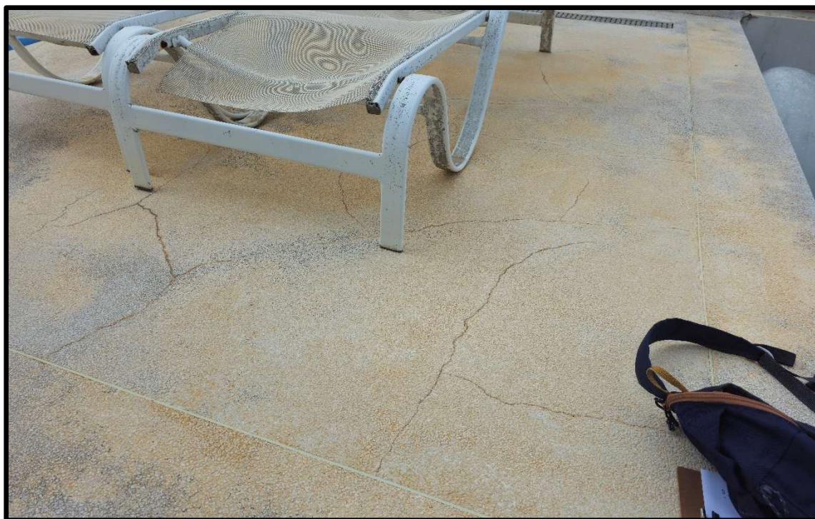
Figura 52: Piso com Fissuração - Área Externa (2º Pavimento)
