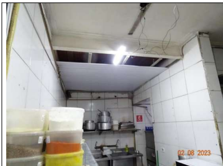
Foto 19. Vista de outro ângulo da cozinha. Nota-se fiação exposta.
