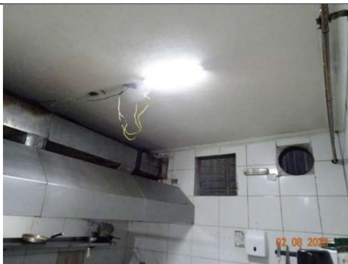
Foto 15. Vista de outro ângulo da cozinha. Nota-se fiação exposta.
