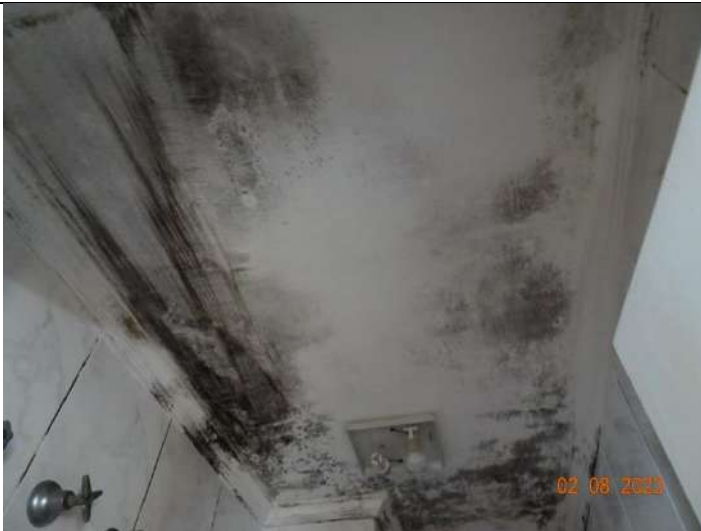
Foto 37. Vista do banheiro social, mostrando o teto com manchas de bolor.
