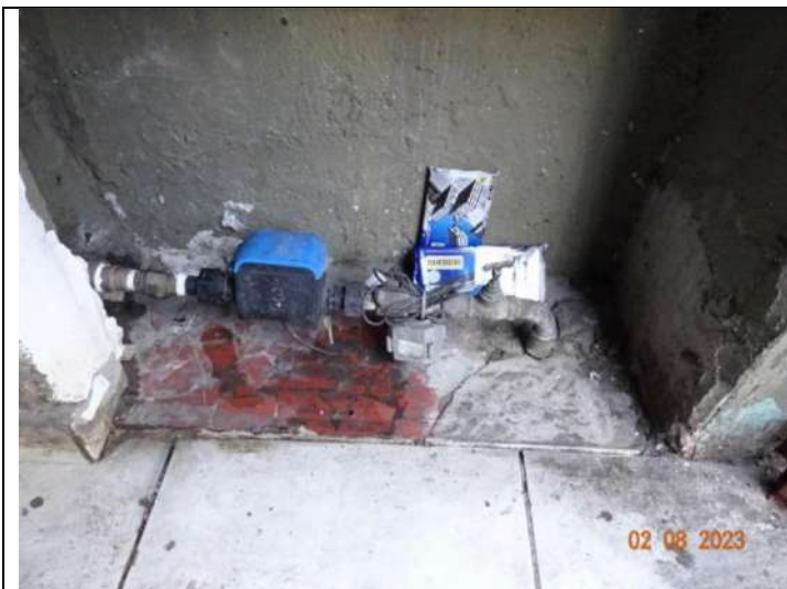
Foto 48. Vista do registro de água.
