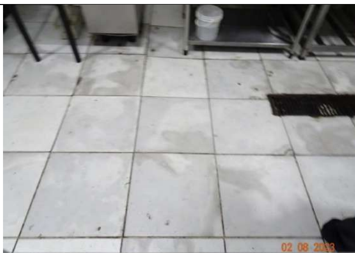
Foto 16. Piso cerâmico da cozinha, apresenta manchas.
