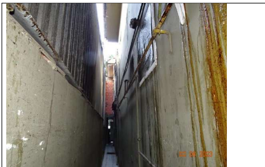
Foto 44. Vista do corredor de circulação externo no pavimento térreo. Nota-se deficiência de acabamentos nas paredes.
