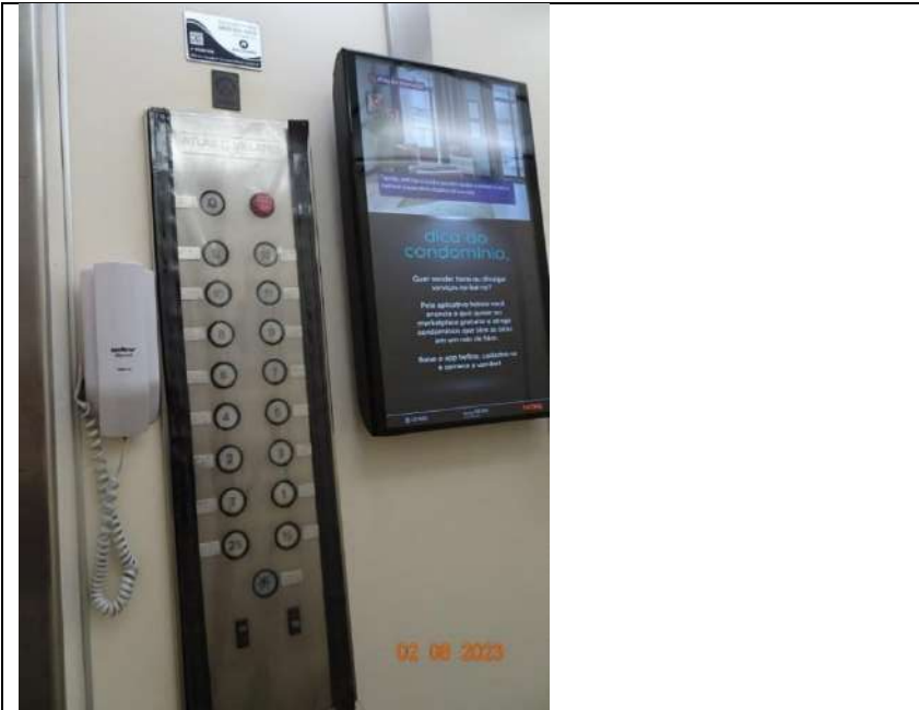
Foto 14. Vista parcial interna do elevador.
